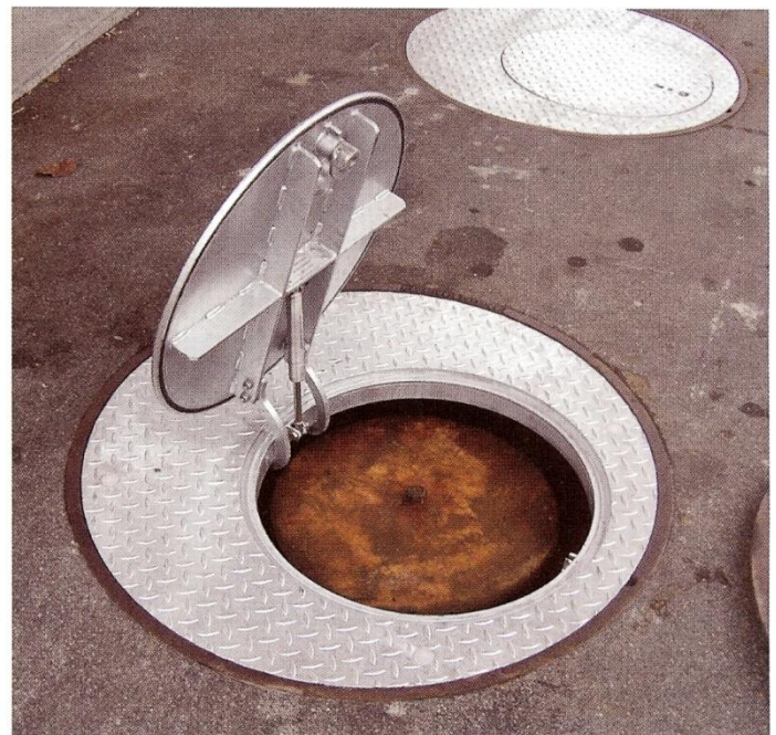
Dank Servohilfe lassen sich die Schachtabdeckungen leicht öffnen.
